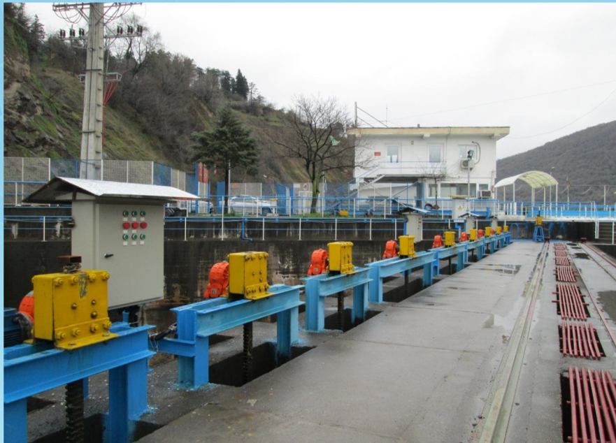
برقی کردن سیستم محرک دریچه‌های تنظیم کننده آب ورودی تونل آب‌ر فومن
